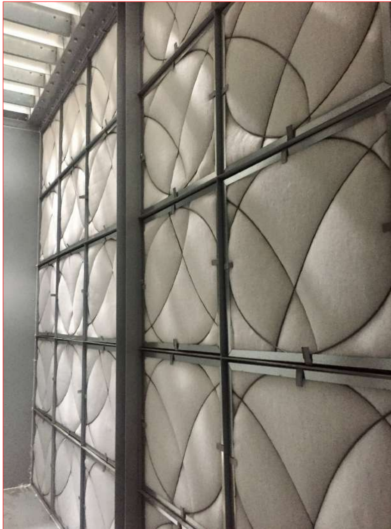
Фильтры приемного блока центрального кондиционера
